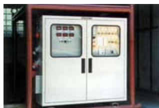
Steuerung für Außenanlagen
